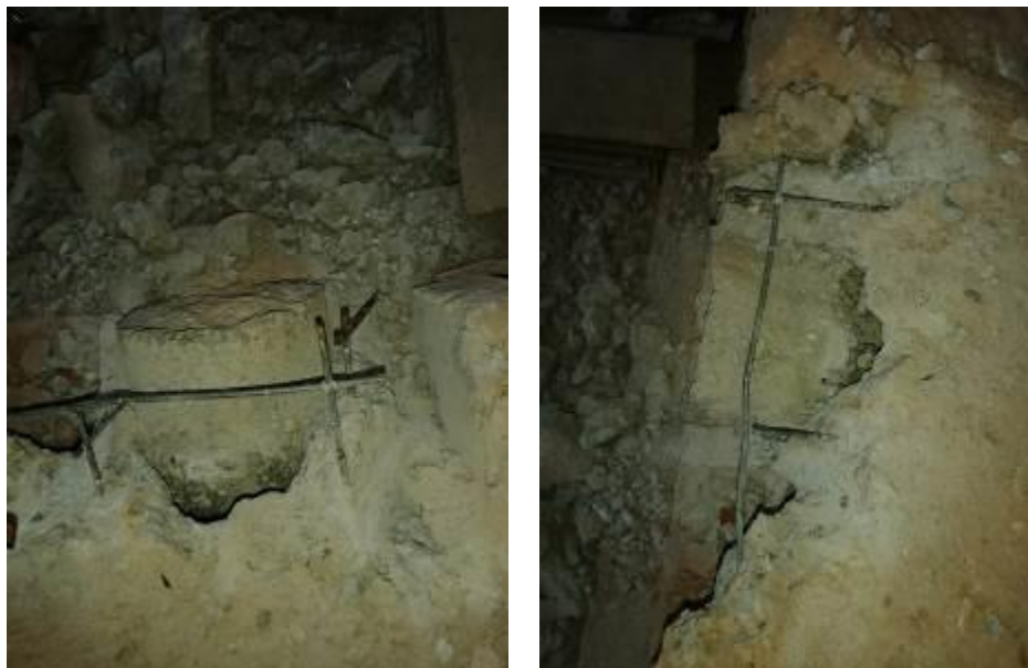
Фото 1-2. Разрушение бетона козырька.
