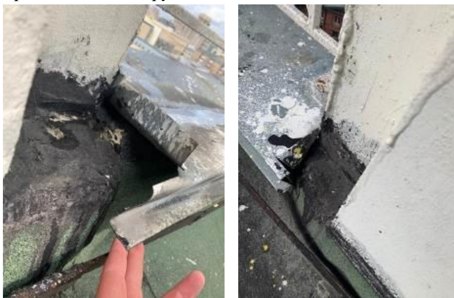
Фото 7-8. Поврежденные металлические элементы.
