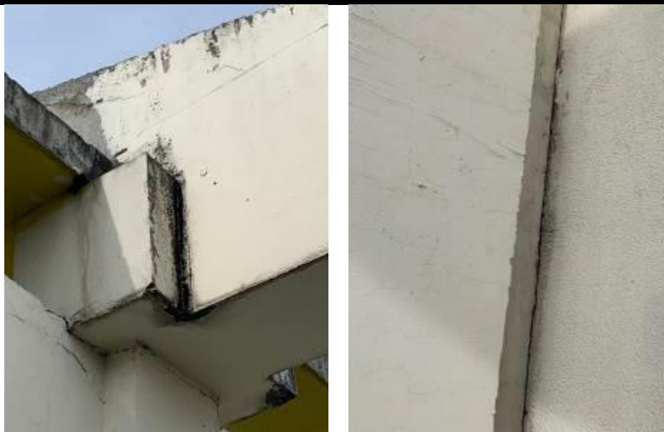
Фото 3-4. Трещины железобетонного козырька.
