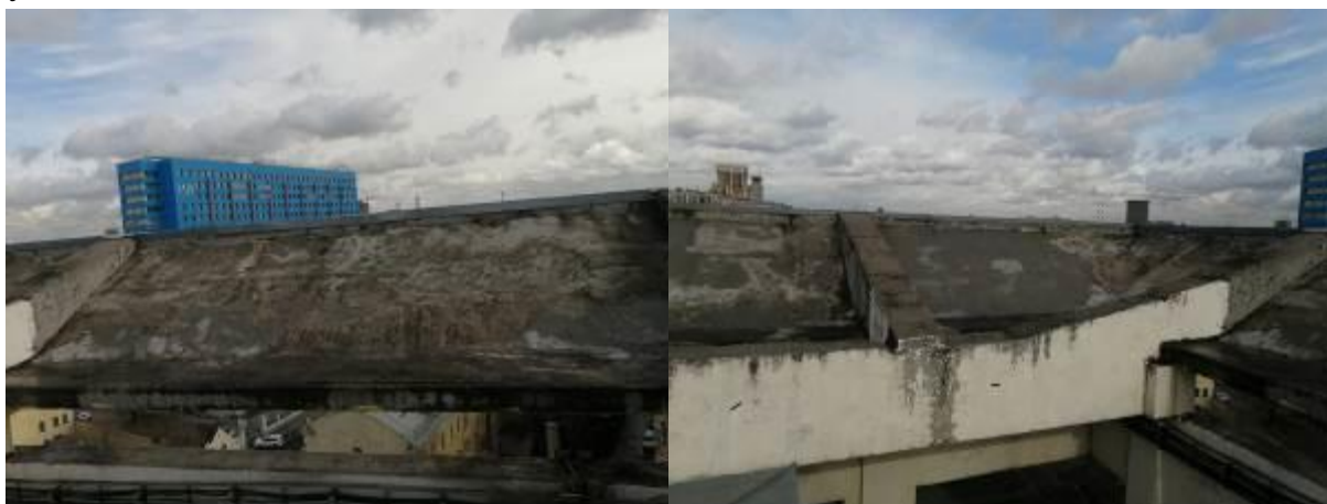
Фото 5-6. Биоповреждения на козырьке.
