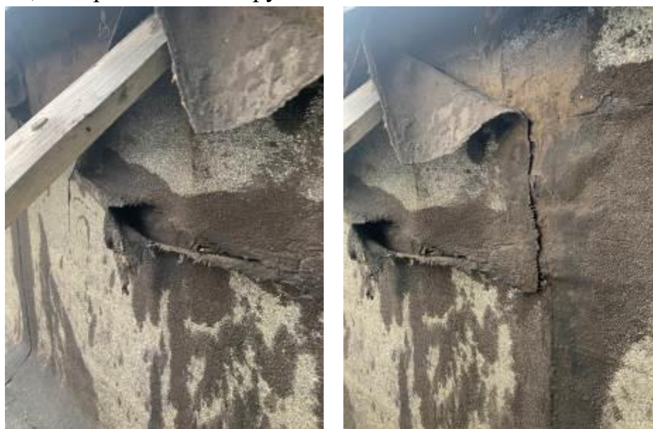
Фото 3-4. Целостность водоизоляционного ковра кровли.
